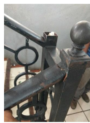
Pasamanos de escalera dañado – Mercado Municipal
