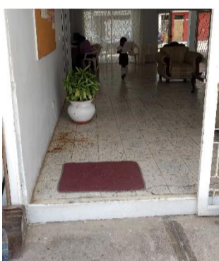
Desnivel en puerta de patio – D.I.F. Municipal
