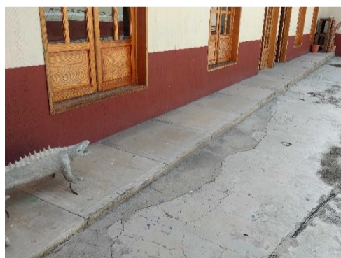
Desnivel en banqueta interior – Casa de la Cultura
