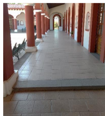
Desnivel en pasillo – Casa de la Cultura
