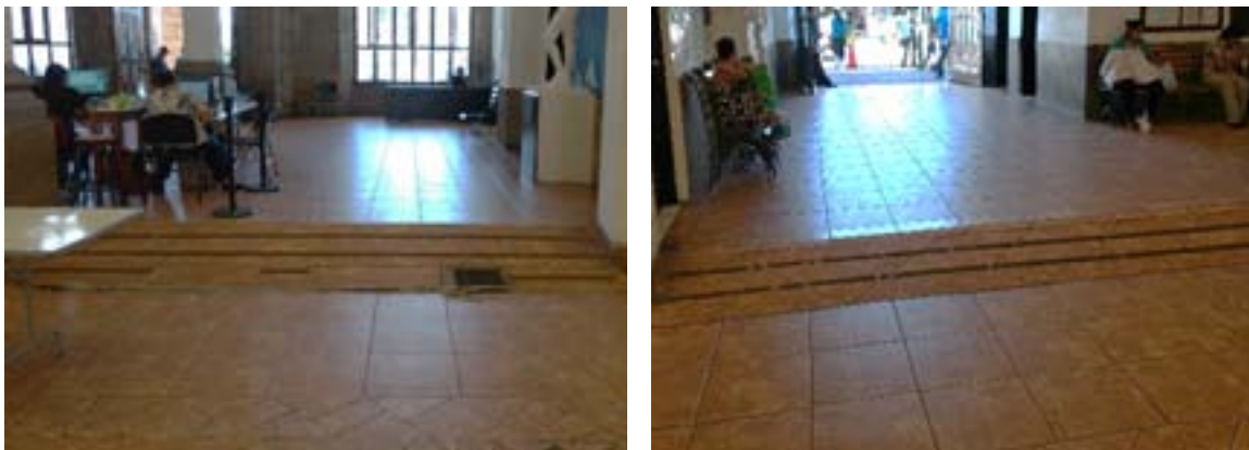
Desniveles en patio central – Presidencia Municipal
